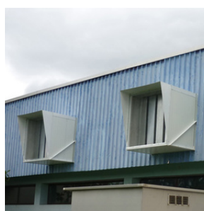
Silencieux de ventilation
